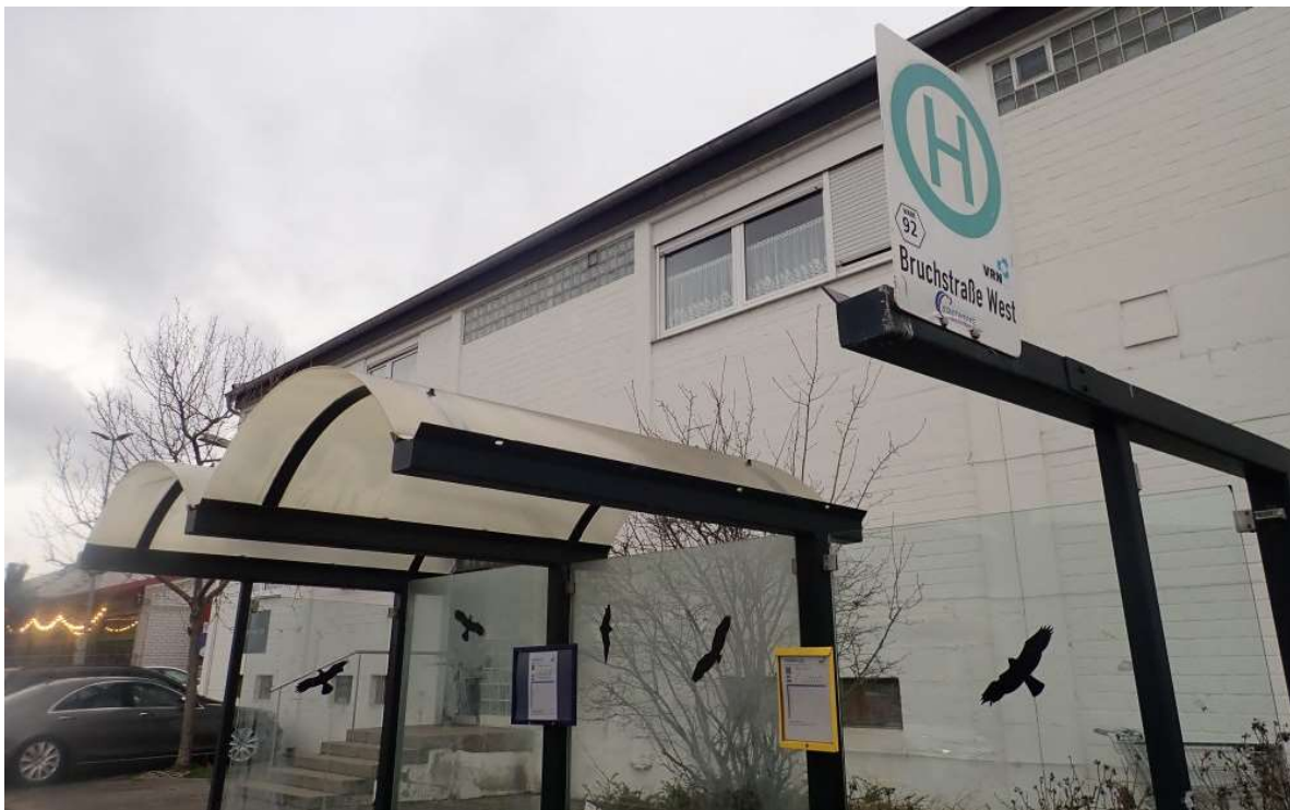
Bad Dürkheim - Haltestelle Bruch West keine Barrierefreiheit, wenig ansprechend, defektes Dach, Kunststoffdächer verspröden regelmäßig und brechen dann (siehe auch am Bad Dürkheimer Busbahnhof wo aktuell wieder mehrere Dächer defekt sind)
